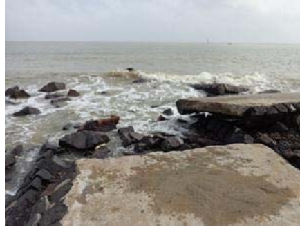
海南海口市镇海侵蚀区西侧波堤毁损严重
