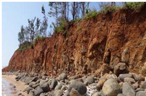
广东雷州市赤坎村海岸侵蚀断面中上部强风化 中风化混合岩石
